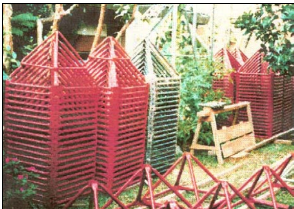
Foto 1. Unit struktur rangka ruang disiapkan dan disusun ditempat kerja, workshop, yang beradadiluar lokasi. Susunan unit struktur yang telah dicat, siap untuk diangkat ke lokasi pembangunan.
